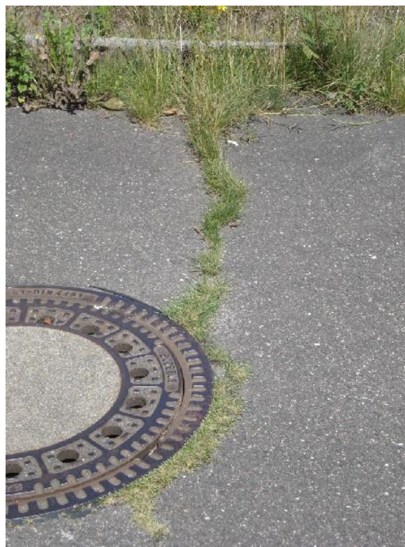
Abb. 29 Der Zustand der Erschließungsstraße zeigt auf gesamter Länge Risse, zu mindestens in der Fahrbahndecke (P. Scharlibbe 13.08.2010)
